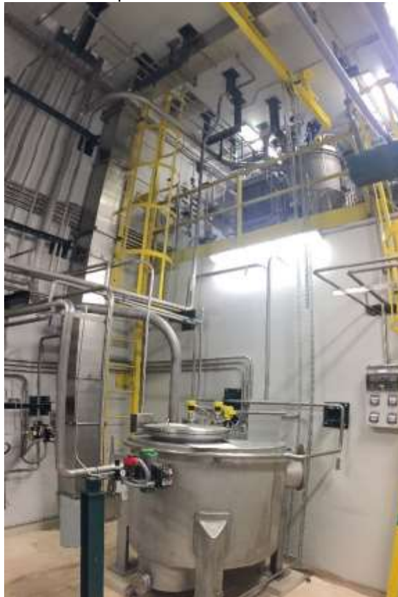
Figura 4: Serbatoi di processo Edificio Condizionamento
